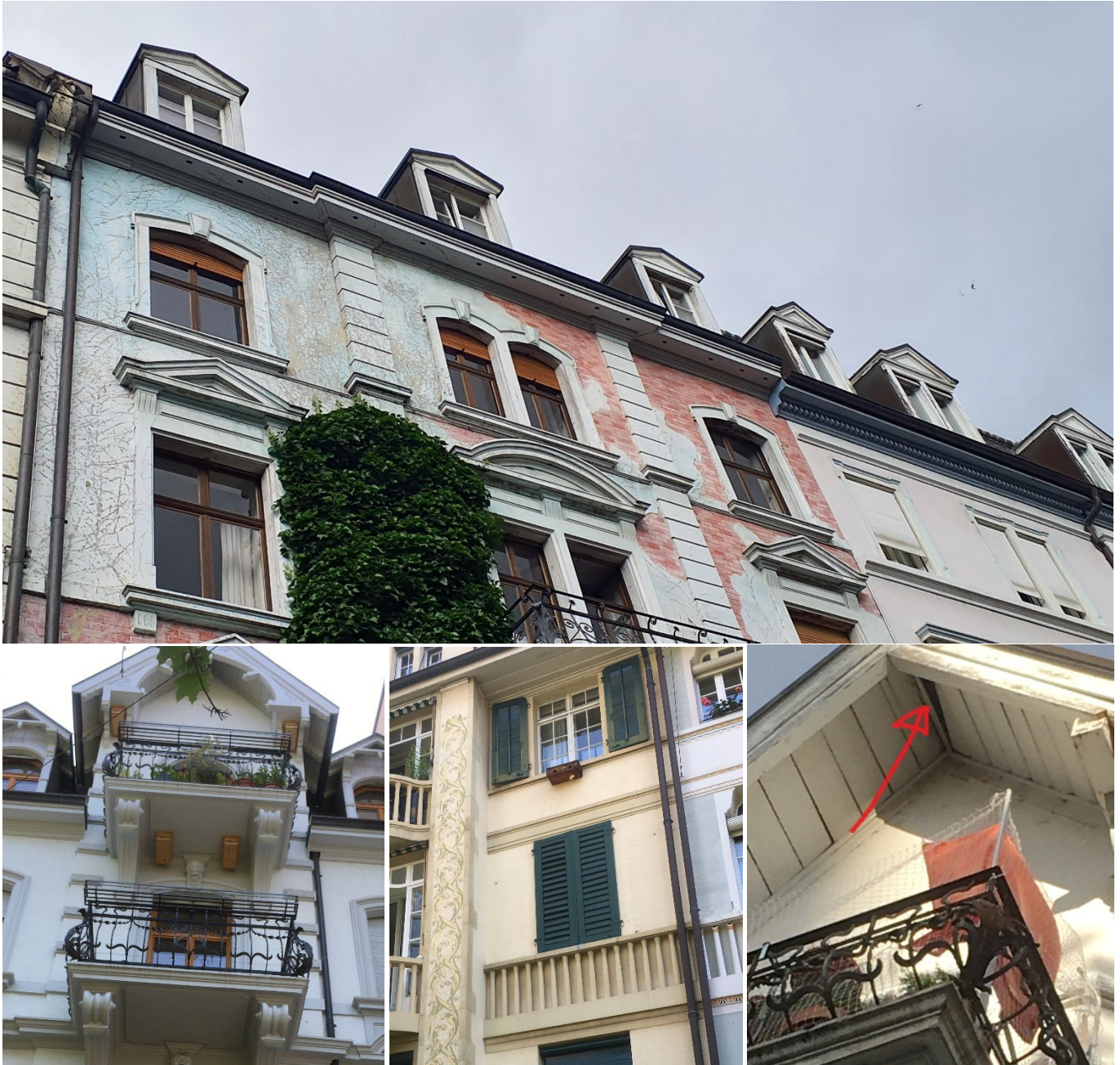
Abb. 8 Die Brutplätze des Mauerseglers in der Stadt Basel sind vielfältig. Sowohl Löcher in der Fassade oder im Unterdach (oben © Franziska Leonhardt), Nisthilfen (unten links und unten Mitte © Alexander Baumgarten) als auch natürliche Nischen im Unterdach (unten rechts, © Alexander Baumgarten) oder unter den Dachziegeln werden gerne genutzt.
